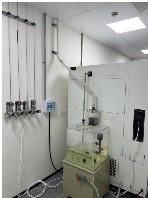
实验室废气收集管道
