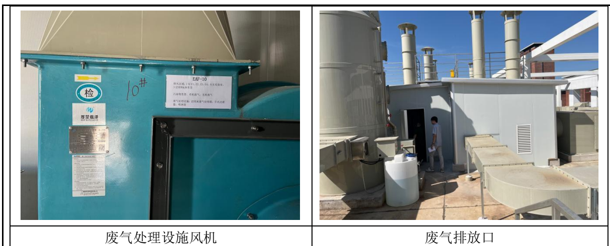
图 3-1 废气处理设施现状图
